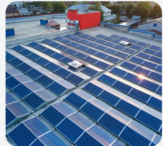
Foto: Zonnepanelen zijn inmiddels een standaard onderdeel van woning of gebouwontwerp in Nederland.
